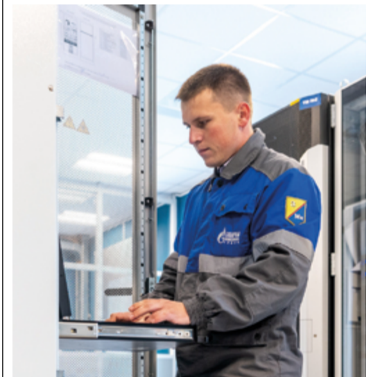
В серверной Свободненского ЛПУ ООО «Газпром трансгаз Томск»
