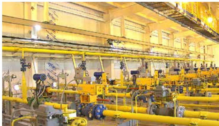
Сборный пункт СП-2 Канчуринско-Мусинского комплекса ПХГ
